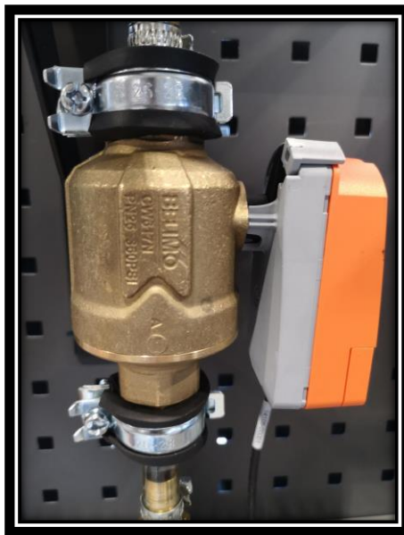
Figur 5-7: Bilde av reguleringsventil og aktuator festet med rørklemmer.
